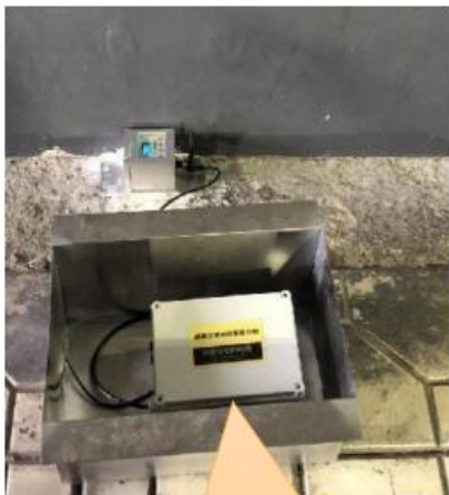
40AH蓄电池，省电模式下支持100天供电
